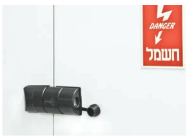
Uzamčení elektrických a rozvodných skříní
