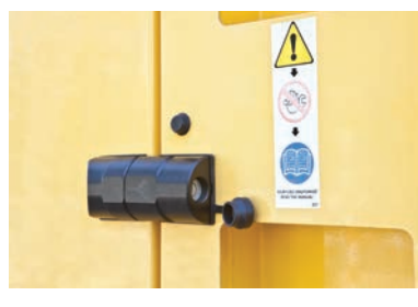
Zajištění záložního generátoru
